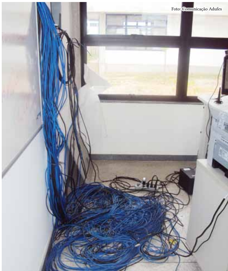
Prédio em situação irregular no Ceunes apresenta problemas na rede elétrica.
